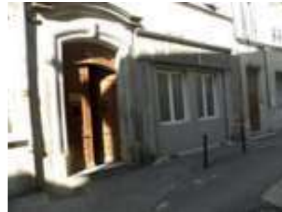
Interventions qui dénaturent les rez-de-chaussée
