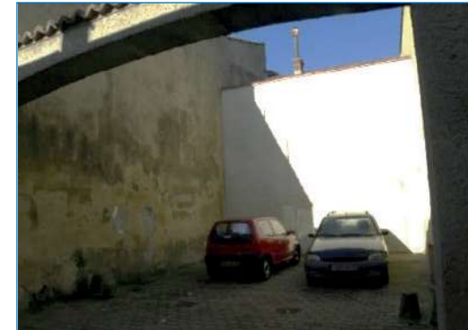
Démolition rue Carnot : éviter de donner à voir des façades non prévues pour être vues
