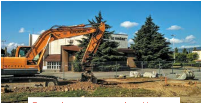
Travaux de terrassement sur le parking du Toueur devant le Théâtre le Rhône.
