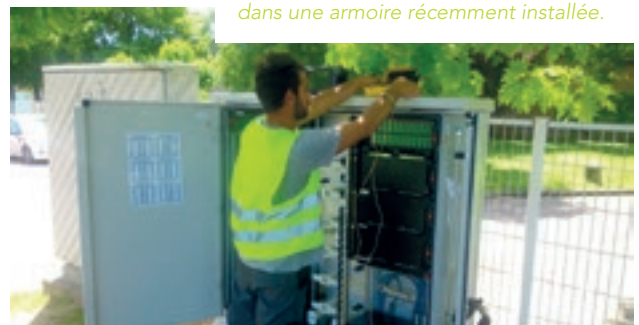
Un technicien Orange vérifie le câblage dans une armoire récemment installée.
